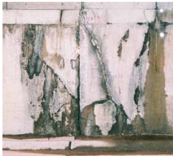
写真-2 側壁コンクリートの圧縮破壊（八幡浜坑口より 40m 付近の海側）
